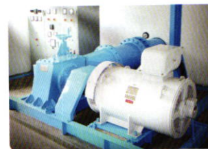
■村に電気を送っている水力発電設備
